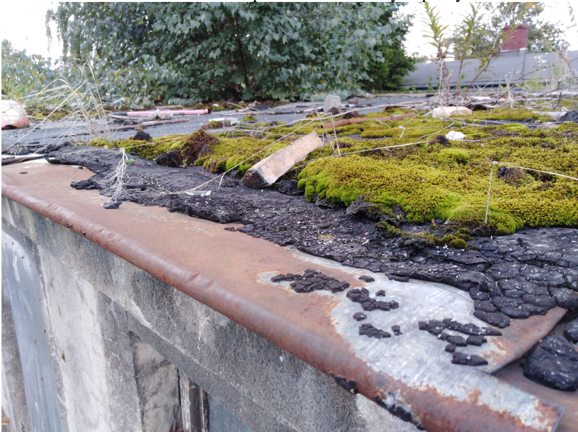
Fot. nr 12 Widoczne zniszczenia powłok bitumicznych pokrycia dachu, powierzchnia porośnięta machami i samosiejkami drzew i krzewów
