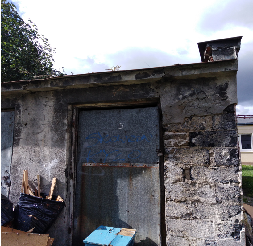
Fot. nr 7 Narożnik od strony północno-wschodniej - widoczne zniszczenia tynków i pustaków żużlobetonowych
