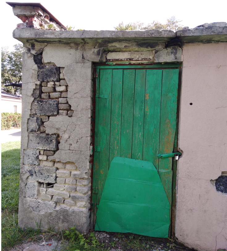
Fot. nr 8 Narożnik od strony północno-zachodniej - widoczne zniszczenia tynków, pustaków żużlobetonowych i cegieł silikatowych
