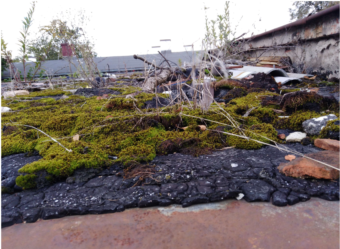
Fot. nr 11 Widoczne uszkodzenia powłoki bitumicznych pokrycia dachu
