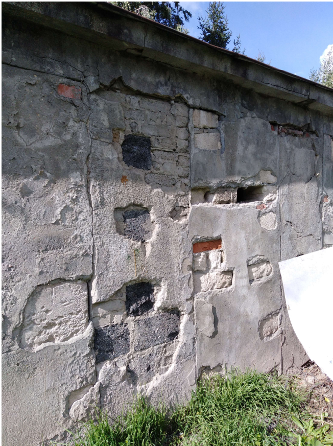
Fot. nr 5 Elewacja podłużna – widoczne uszkodzenia i spękania ściany
