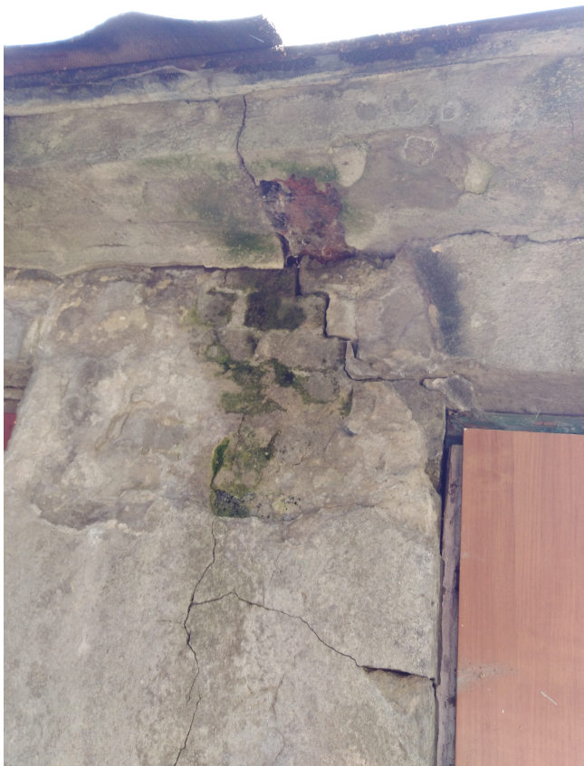
Fot. nr 6 Fragment ściany i gzymsu - widoczne spękania cegieł i gzymsu
