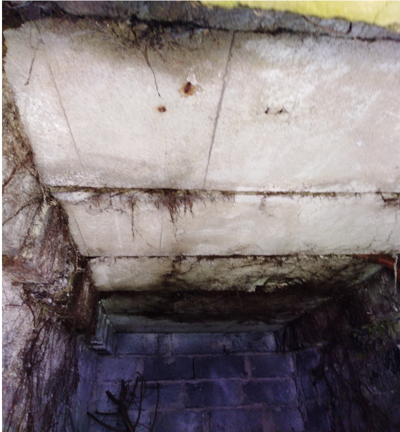
Fot. nr 9 Widok płyt dachowych żelbetowych i pustaków żużlobetonowych - widoczne zawilgocenia i uszkodzenia ścian i stropów, brak wieńców
