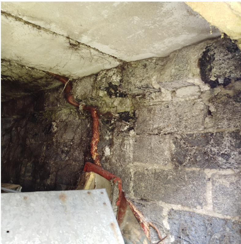
Fot. nr 10 Widok płyt dachowych żelbetowych i pustaków żużlobetonowych - widoczne zawilgocenia i uszkodzenia ścian i stropów
